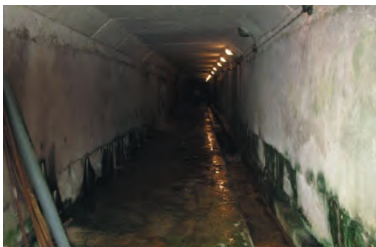
Рисунок 5.3 – Фильтрация воды в потернах бетонной плотины
